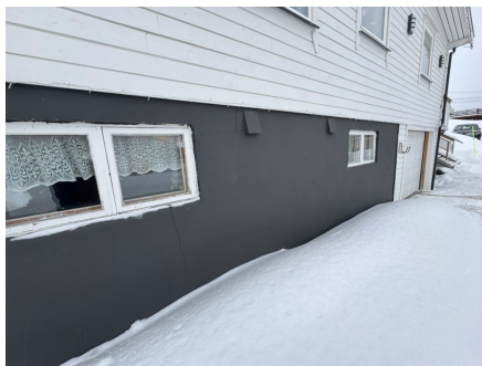
Eksempel på sprekkdannelse i grunnmuren.
