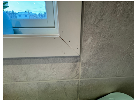
Fuktskader på listverk.
