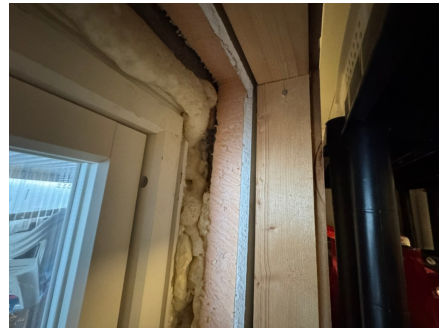
Synlig isopor ved vinduet i underetasjen.
