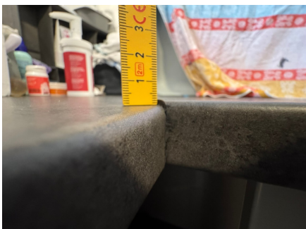
Stor høydeforskjell i benkeplaten ved skjøten.
