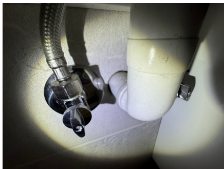
Det er ikke tett rundt avløpsrøret.
