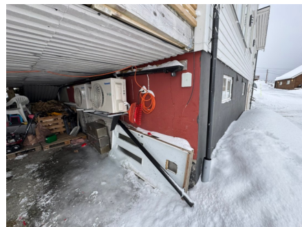
Eksempel på sprekkdannelse i grunnmuren.
