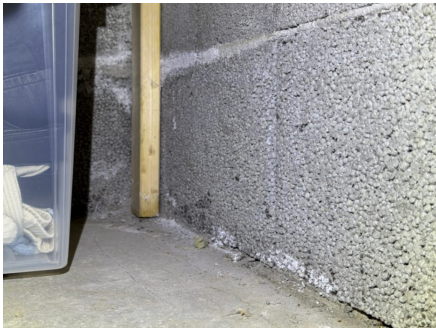
Tegn til slatutslag på grunnmuren.
