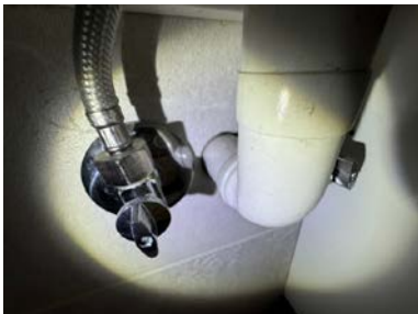
Det er ikke tett rundt avløpsrøret.
