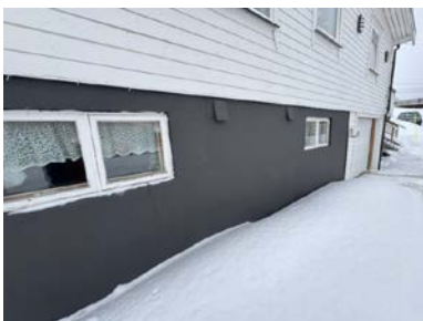
Eksempel på sprekkdannelse i grunnmuren.
