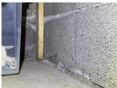
Tegn til saltutslag på grunnmuren.
