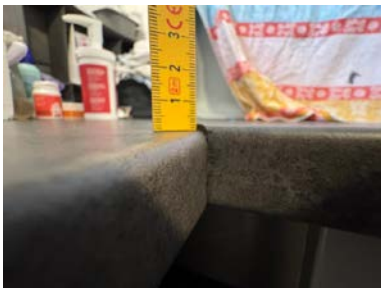
Stor høydeforskjell i benkeplaten ved skjøten.
