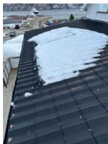
Det er ikke montert snøfangere over hele altanen.
