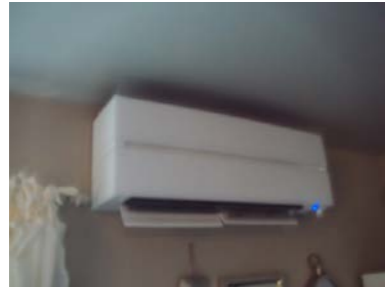
Varmepumpe i stue.
