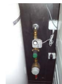
Innvendig stoppekran med vannmåler.
