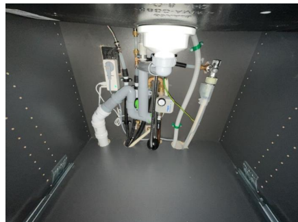
Vanntilførsel i kjøkken med lekkasjesensor.
