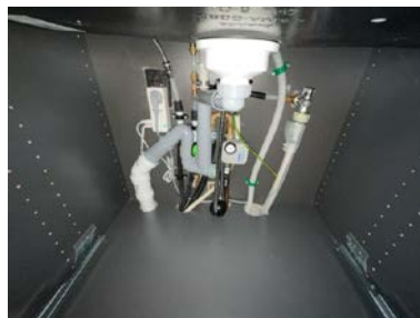
Vanntilførsel i kjøkken med lekkasjesensor.
