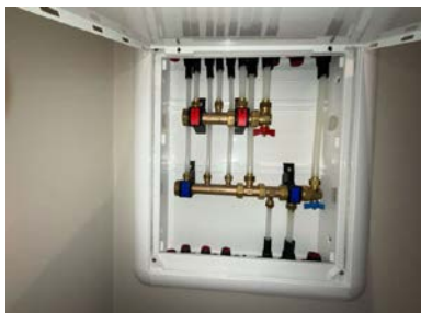
Fordelerskap til bad.
