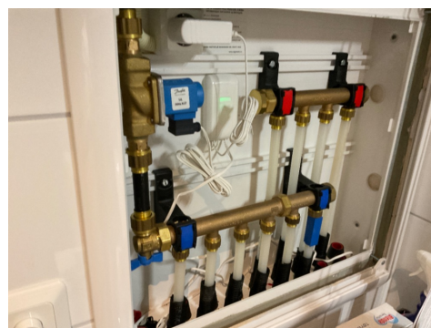
Rør i rør skap på baderom
