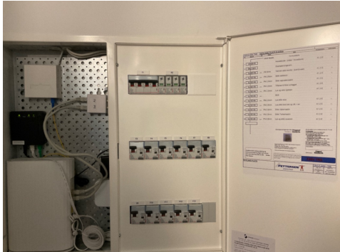
Sikringsskap i bode
