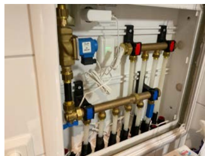
Rør i rør skap på baderom
