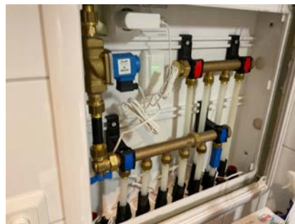
Rør i rør skap på baderom
