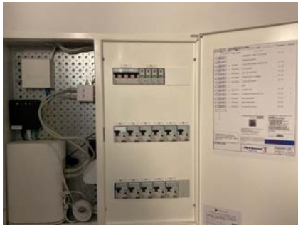
Sikringsskap i bode
