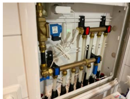
Rør i rør skap på baderom
