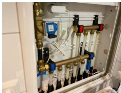
Rør i rør skap på baderom
