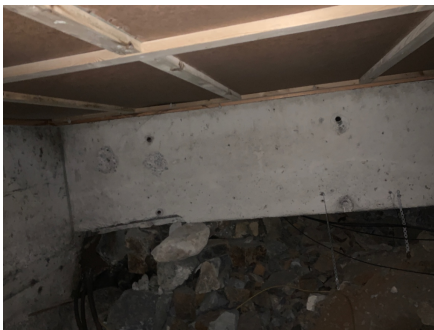
Ikke inspisert bak betongdrager
