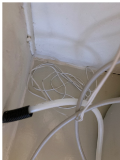
Følerledning er ikke lagt som tiltenkt
