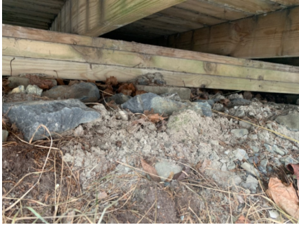
Ikke tilfredstillende og frostfri fundamentering
