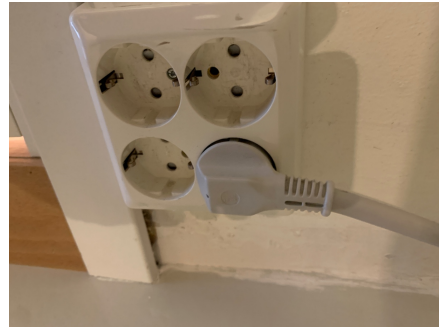
Stikkontakt tilkobling er ikke forskriftsmessig
