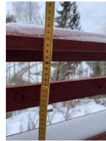
For lavt rekkverk og liggende bord
