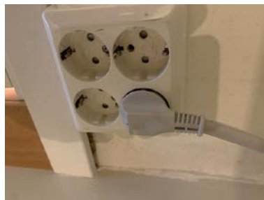
Stikkontakt tilkobling er ikke forskriftsmessig
