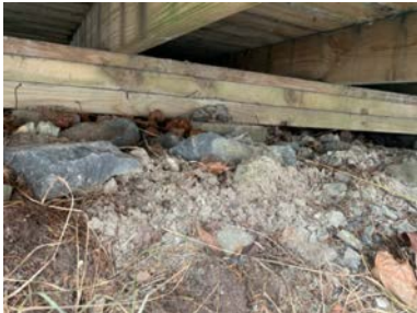
Ikke tilfredstillende og frostfri fundamentering
