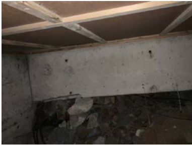
Ikke inspisert bak betongdrager
