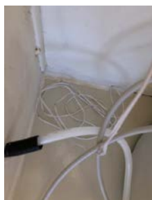
Følerledning er ikke lagt som tiltenkt
