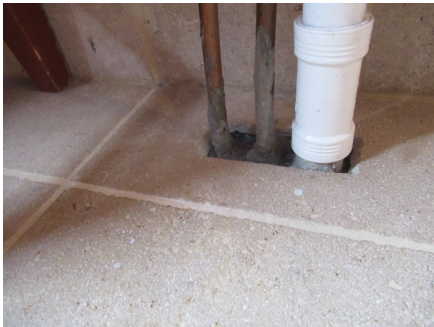
Ingen synlig mansjett i rørgjennomføring for vask og gjenstående arbeid.
