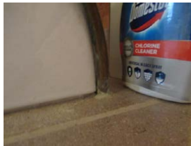
Ingen synlig membran i røroppstikk til wc
