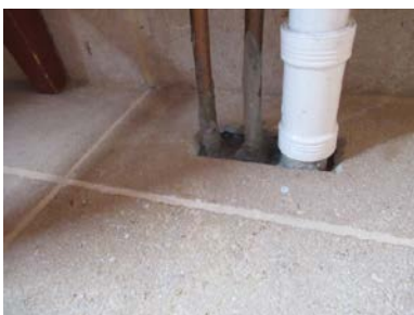
Ingen synlig mansjett i rørgjennomføring for vask og gjenstående arbeid.
