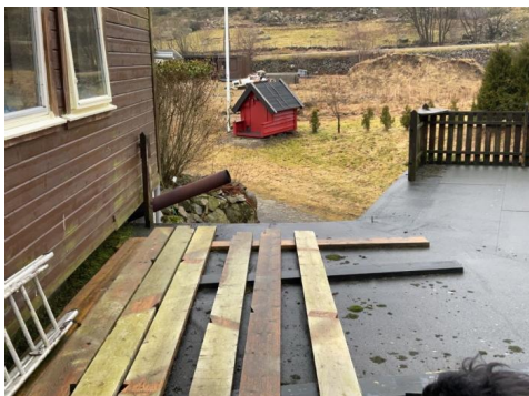
Terrasse/garasjetak mangler rekkverk.
