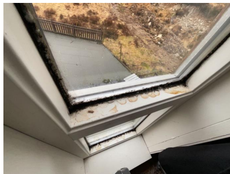
Svertesopp og fuktmerker i vinduskarm i soverom på hems.
