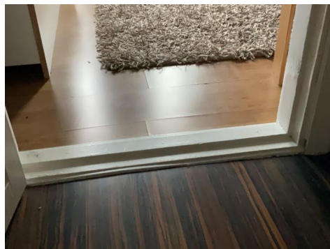
Toppinger i enkelte laminatskjøter på gulv hems.
