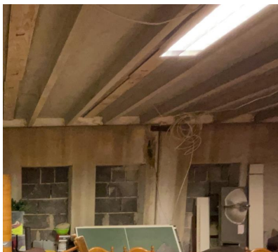
Løse ledninger i underetasje.
