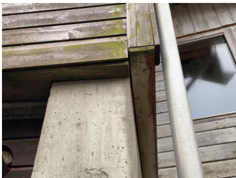
Spalte bak kledning er tettet med terrassebord.
