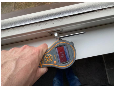
Fuktskader og indikasjoner på fukt i foring til vindu i bad.
