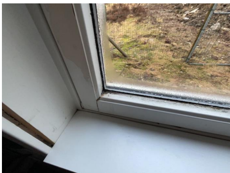
Kondens i vinduskarmer i bad.
