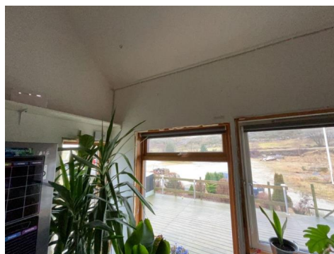
Det mangler belistning rundt vinduer i kjøkken.
