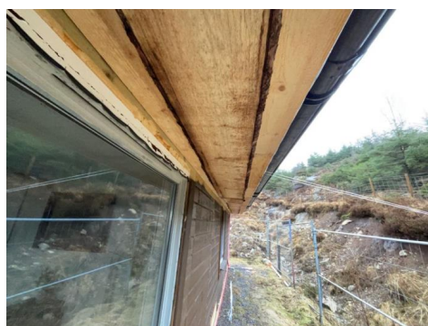
Takkonstruksjon på tilbygg er ikke luftet.
