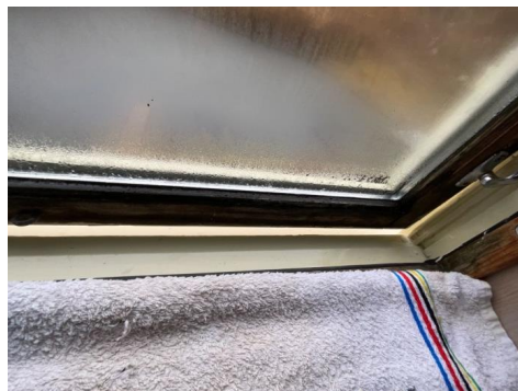
Fuktige overflater i vinduskarm i soverom på befaringsdagen.
