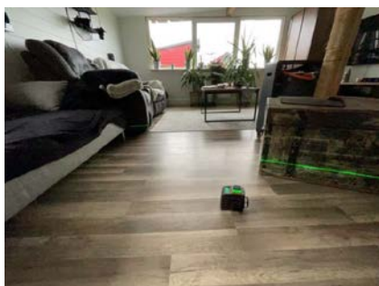
Store retningsavvik på gulv i stue.
