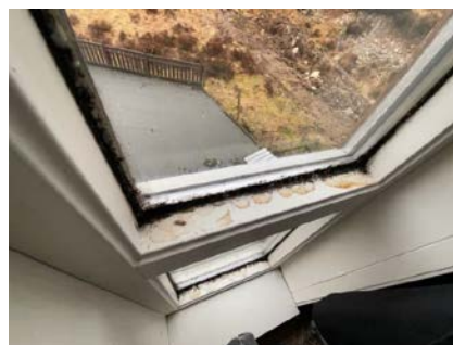
Svertesopp og fuktmerker i vinduskarm i soverom på hems.
