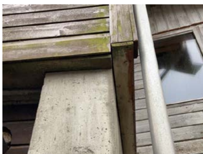
Spalte bak kledning er tettet med terrassebord.
