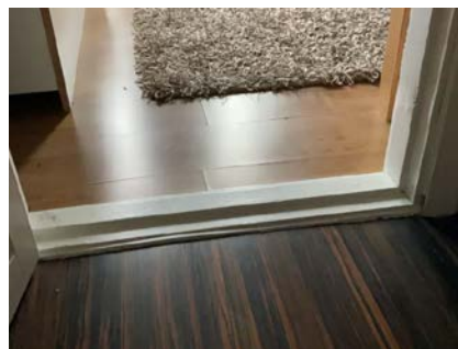
Toppinger i enkelte laminatskjøter på gulv hems.
