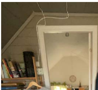
Ledninger på hems ikke tilstrekkelig festet.
