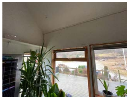
Det mangler belistning rundt vinduer i kjøkken.
