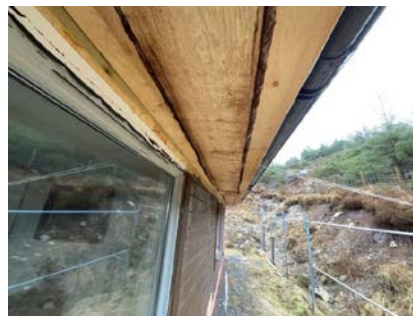
Takkonstruksjon på tilbygg er ikke luftet.
