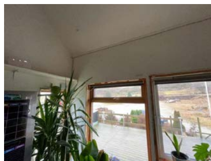
Det mangler belistning rundt vinduer i kjøkken.
