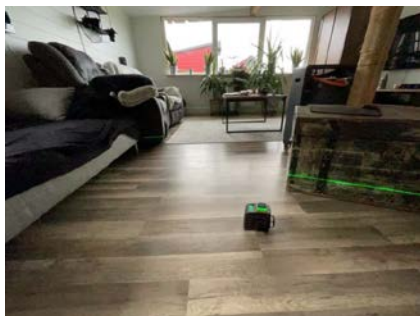
Store retningsavvik på gulv i stue.
