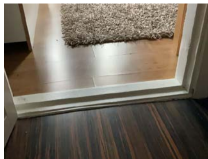
Toppinger i enkelte laminatskjøter på gulv hems.
