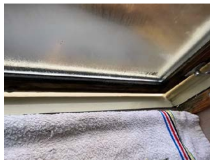
Fuktige overflater i vinduskarm i soverom på befaringdagen.
