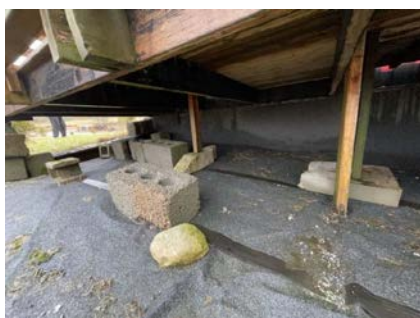
Søyler under terrasse er underdimensjonerte og enkelte av disse står rett ned på duk på terreng.
