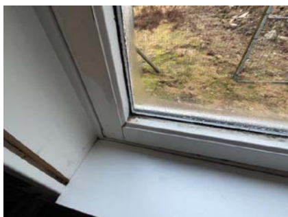
Kondens i vinduskarmer i bad.
