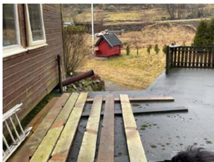
Terrasse/garasjetak mangler rekkverk.
