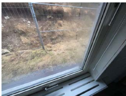
Kondens i vinduskarmen i soverom og bad.
