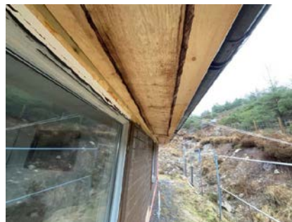
Takkonstruksjon på tilbygg er ikke luftet.
