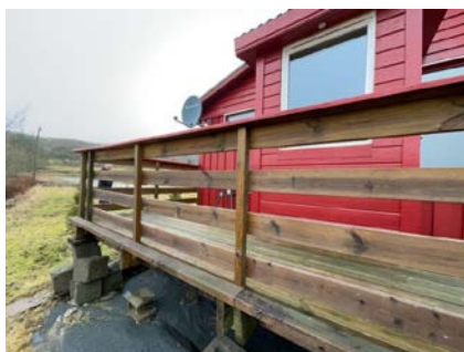
Åpninger i rekkverk er for store iht. krav til rekkverk i dagens forskrifter.
