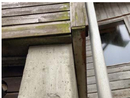
Spalte bak kledning er tettet med terrassebord.
