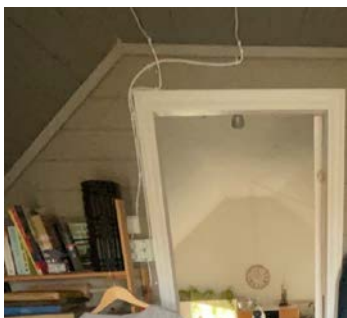
Ledninger på hems ikke tilstrekkelig festet.
