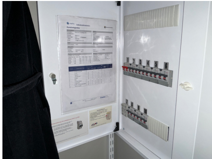
Automatsikringer i sikringskap plassert i entré m/bodskap.
