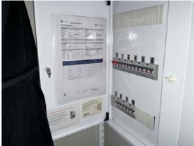
Automatsikringer i sikringskap plassert i entré m/bodskap.
