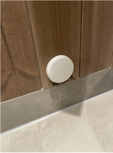
Drenering fra rørfordelerskap.
