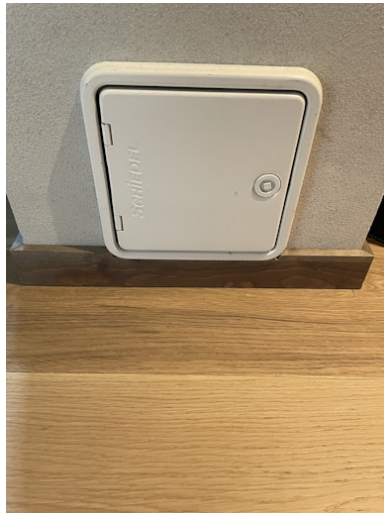
Manglende ubrennbar plate foran feieluke.
