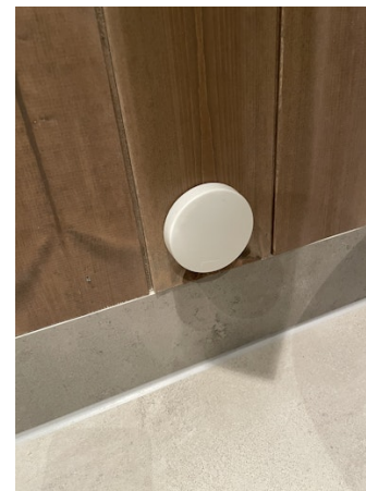
Drenering fra rørfordelerskap.
