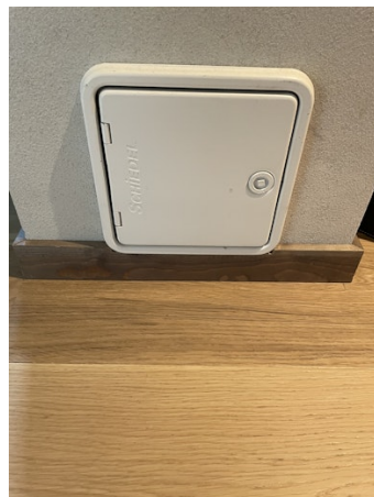
Manglende ubrennbar plate foran feieluke.
