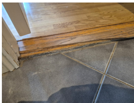
Sprukket terskel på bad.
