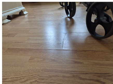
Fuktsveller i laminatgulv.
