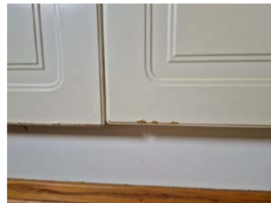
Fuktsveller på front.
