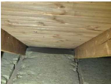
Lite lufting i nedre del av konstruksjon.
