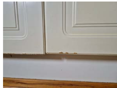
Fuktsveller på front.
