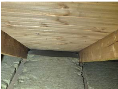
Lite lufting i nedre del av konstruksjon.
