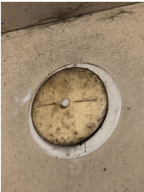
Soppdannelse rundt ventil i garasje. Kan vaskes bort.
