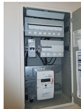
Sikringsskap med automatsikringer.
