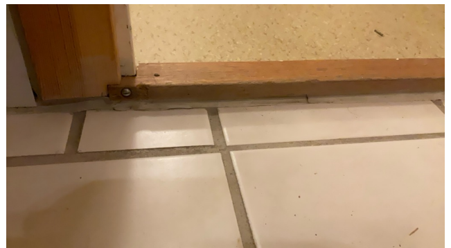
Sprekk i silikonering mot dørterskel.
