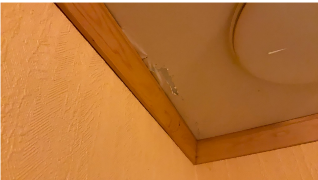
Skade i himlingsplate.
