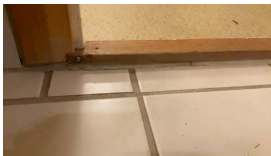
Sprekk i silikonering mot dørterskel.
