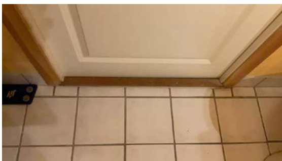
Ingen ventilering ved terskel.
