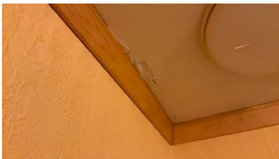
Skade i himlingsplate.
