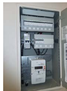
Sikringsskap med automatsikringer.
