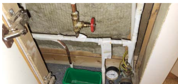
Vannrør i luke i gang underetasje.
