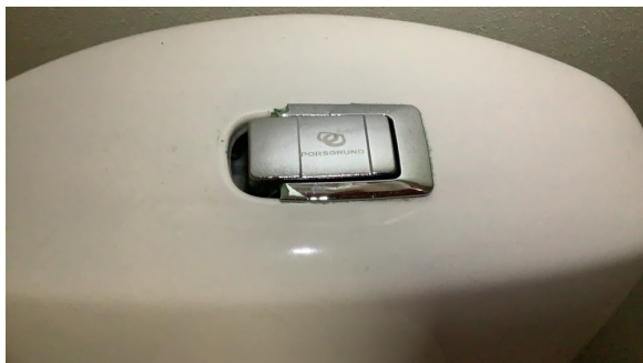
Skadet deksel rundt spyleknapp.
