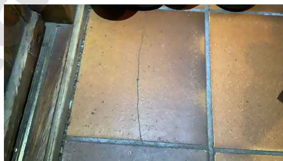
Sprukket gulvflis i vindfang.
