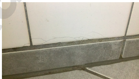
Eksempel på sprukket flis.
