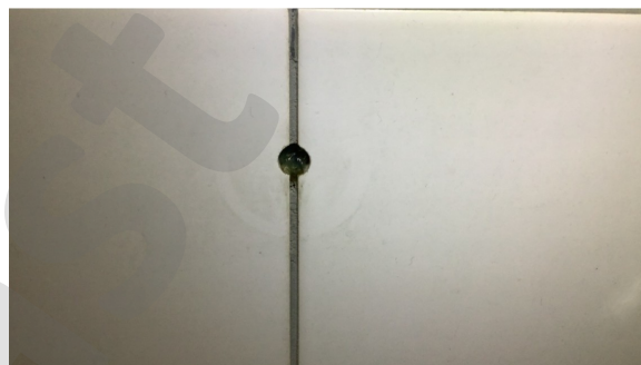
Eksempel på hull etter tidligere montert utstyr som er fylt med silikon.
