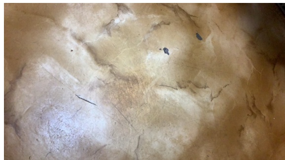
Eksempel på skader og rift i vinylbelegget.
