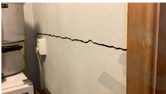
Sprekk i murvegg i matbod.
