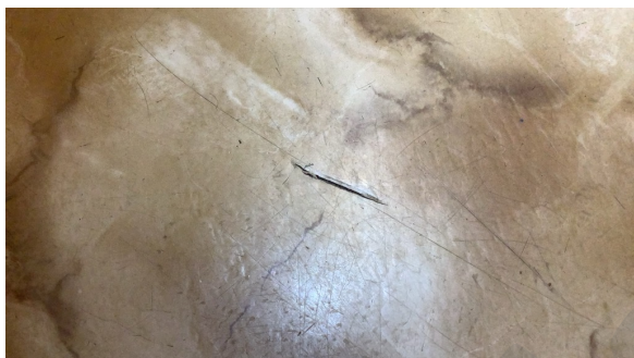
Eksempel på sprekk i vinylbelegg.
