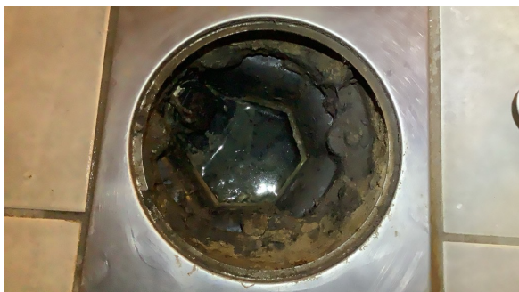
Plastsluk. Det er synlig membran rundt sluk, men det er ikke synlig om denne er ført under slukets klemring.
