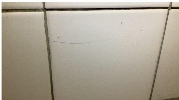
Eksempel på sprukket flis.
