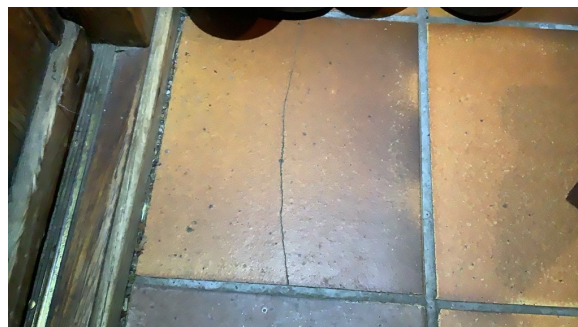
Sprukket gulvflis i vindfang.
