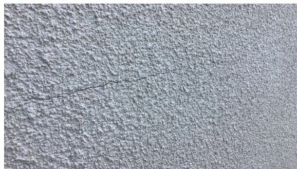
Eksempel på riss.
