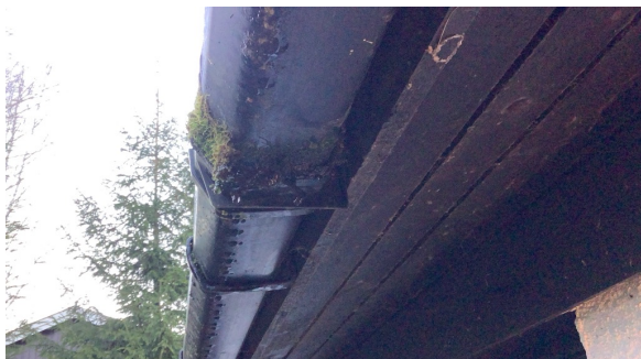
Eksempel på lekkasje i takrenneskjøt.
