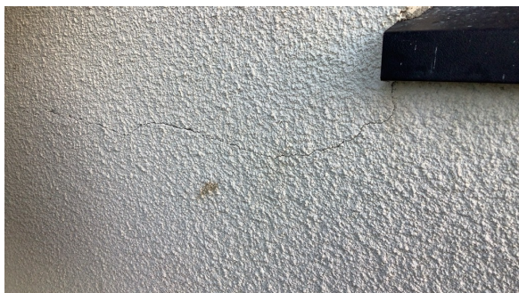
Eksempel på riss.
