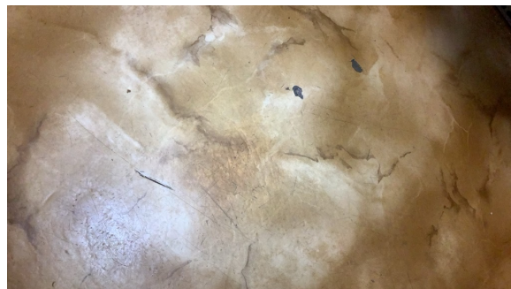
Eksempel på skader og rift i vinylbelegget.
