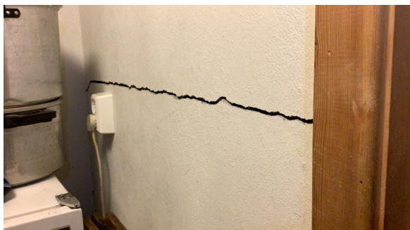
Sprekk i murvegg i matbod.
