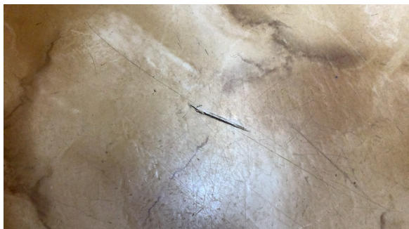
Eksempel på sprekk i vinylbelegg.
