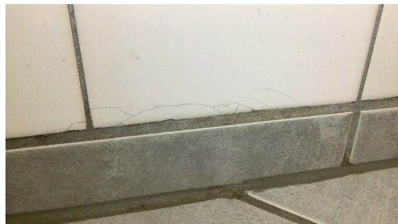
Eksempel på sprukket flis.
