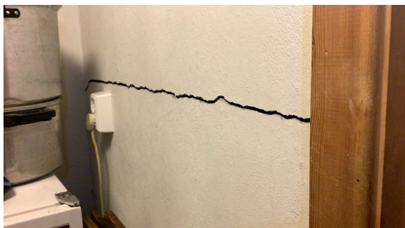
Sprekk i murvegg i matbod.
