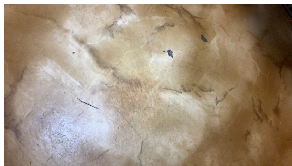
Eksempel på skader og rift i vinylbelegget.
