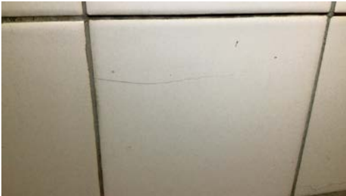
Eksempel på sprukket flis.
