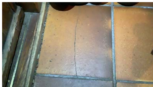
Sprukket gulvflis i vindfang.
