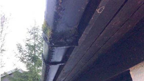
Eksempel på lekkasje i takrenneskjøt.
