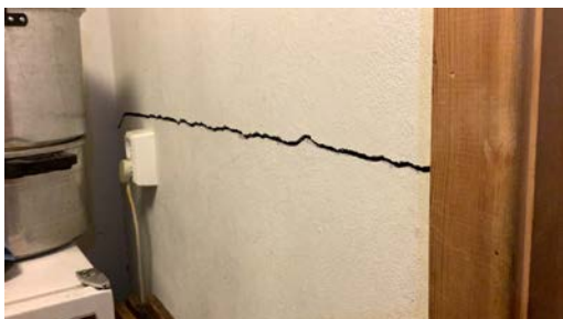
Sprekk i murvegg i matbod.
