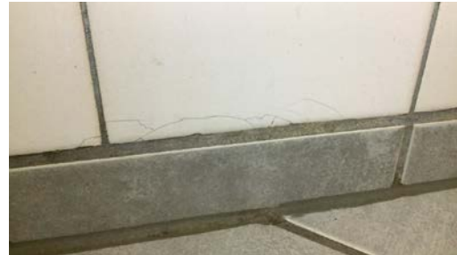
Eksempel på sprukket flis.
