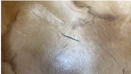
Eksempel på sprekk i vinylbelegg.
