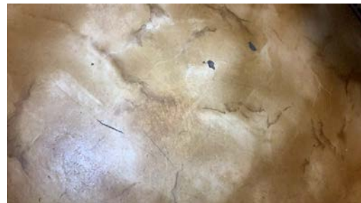
Eksempel på skader og rift i vinylbelegget.
