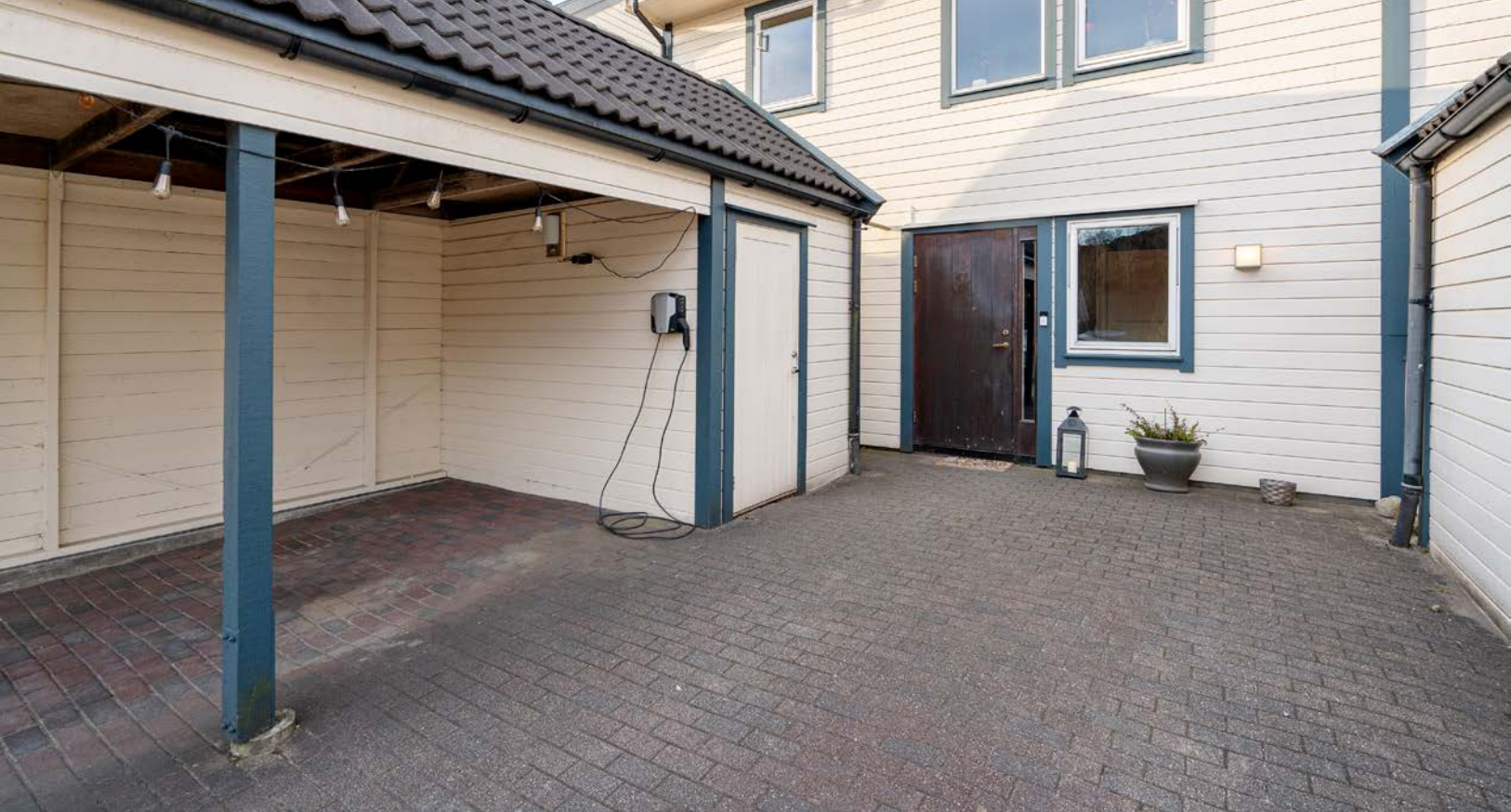
El-lader er montert i carport
