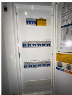
Sikringsskap med automatsikringer.
