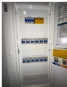
Sikringsskap med automatsikringer.
