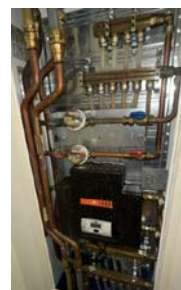
Samleskap med rørkurser og stoppekraner
