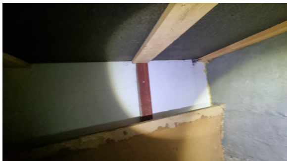
Åpen isopor i krypkjeller under tilbygget spisestue.
