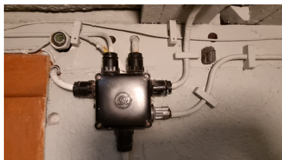
En del eldre el-installasjon i kjeller.
