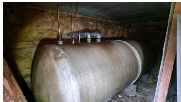
Oljetanken ligger i krypkjeller med utvendig adkomst
