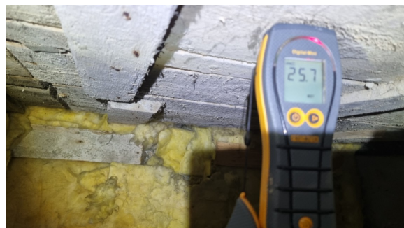
Fuktmåling i stubbloft i krypkjeller med utvendig adkomst. Forhøyede fuktverdier ble registrert. Dette skyldes for lite lufting
