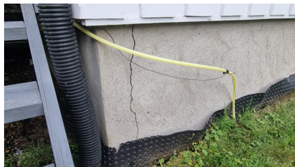
Sprekk i grunnmur.
