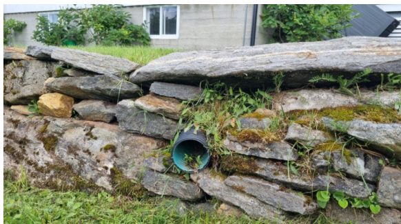
Takvannet blir ledet bort.
