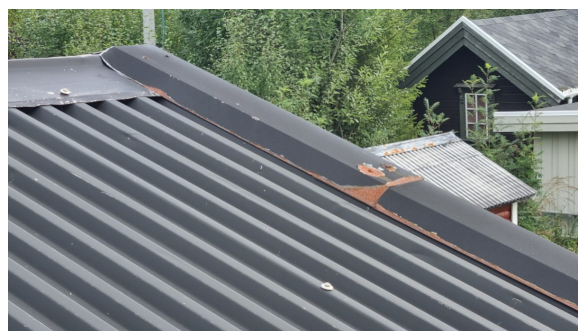
Rust i beslag.
