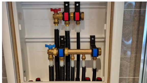
Kontroll av fordelerskapet.
