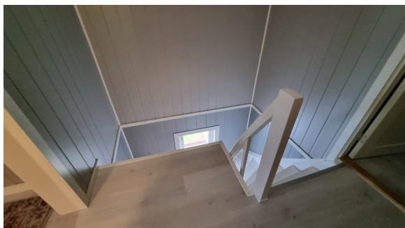
Manglende rekkverk i loftsetasje
