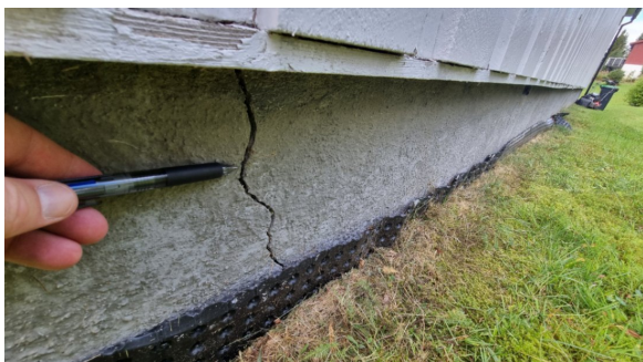
Sprekk i grunnmur.
