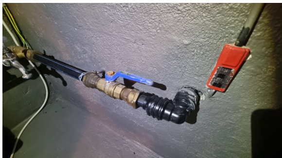
Kontroll av innvendig hovedstoppekran.
