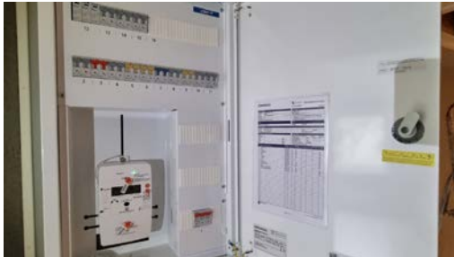
Kontroll av el-skapet.
