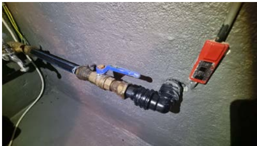
Kontroll av innvendig hovedstoppekran.
