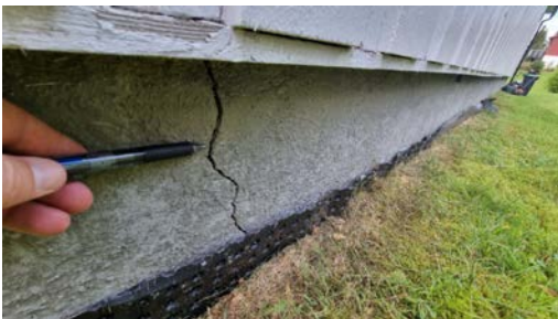
Sprekk i grunnmur.
