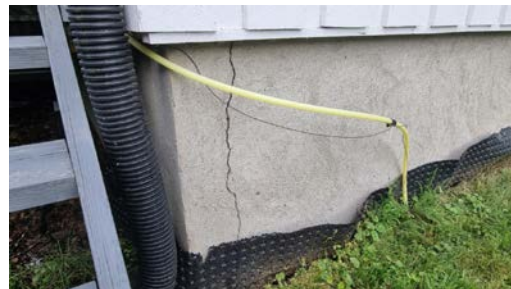
Sprekk i grunnmur.
