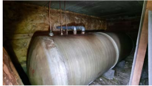
Oljetanken ligger i krypkjeller med utvendig adkomst
