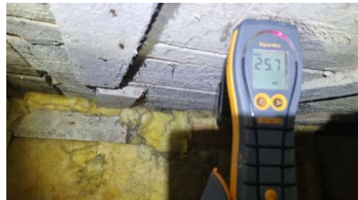
Fuktmåling i stubbloft i krypkjeller med utvendig adkomst. Forhøyede fuktverdier ble registrert. Dette skyldes for lite lufting
