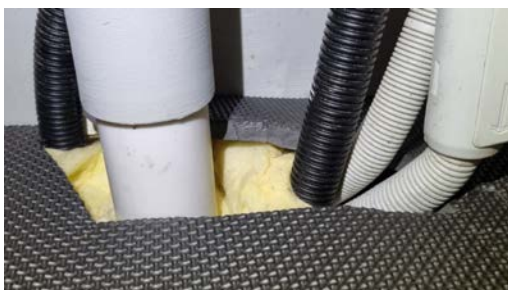
Det er tettet med isolasjon ved rørgjennomføring i gulvet.
