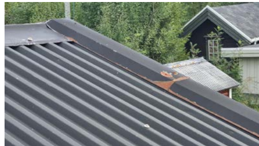
Rust i beslag.
