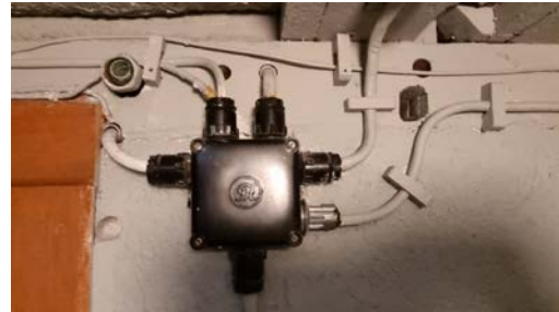
En del eldre el-installasjon i kjeller.
