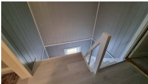
Manglende rekkverk i loftsetasje
