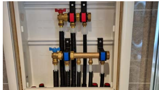
Kontroll av fordelerskapet.
