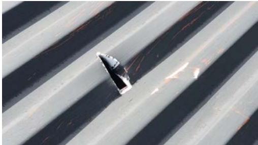
Hull i taktekket.
