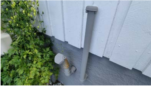
Utvendige påfyllingsrør til oljetanken.
