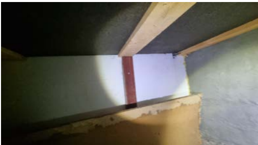
Åpen isopor i krypkjeller under tilbygget spisestue.
