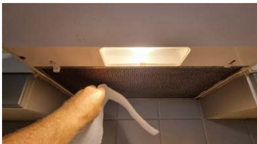
Funksjonstesting av avtrekk over komfyr.
