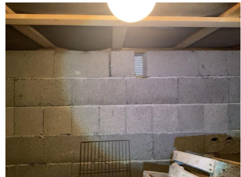
Ringmursventiler i grunnmur.
