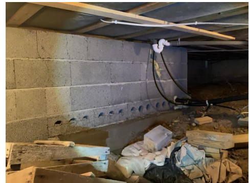
Vertikalriss i ringmur, sannsynligvis grunnet differensialsetninger i grunnen.
