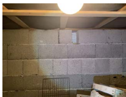
Ringmursventiler i grunnmur.
