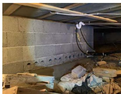
Vertikalriis i ringmur, sannsynligvis grunnet differensialsetninger i grunnen.
