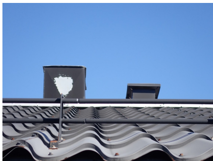
Rustmerker i snøfangere, løs folie i beslag.
