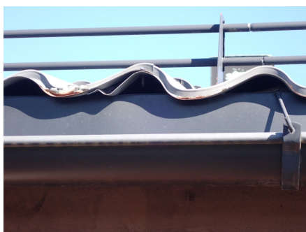
Løs folie / rustskader i takplater over takrenner
