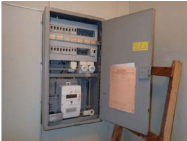
Sikringskap med automatsikringer og automatisk strømmåler.
