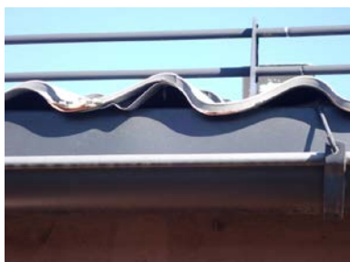
Løs folie / rustskader i takplater over takrenner
