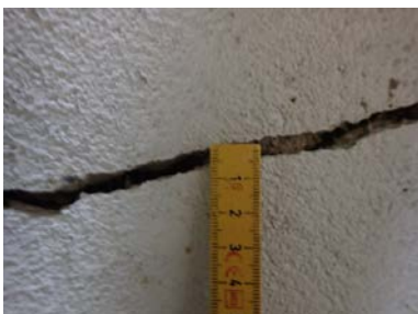
Sprekk i innvendig murpuss
