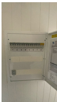
Sikringsskap er plassert i vindfang
