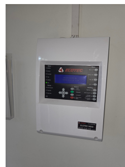
Felles brannsentral i felles gang ved hovedinngang
