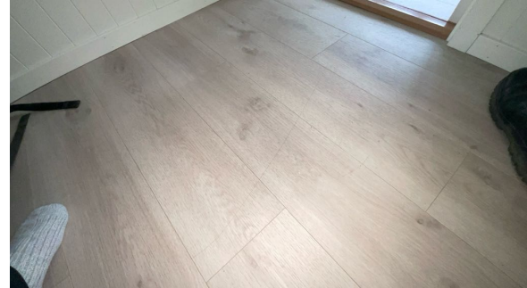
Slitasje/striper på gulv i vindfang
