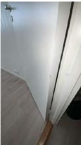
Kantskade på dør mellom vindfang og stue
