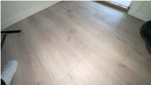
Slitasje/striper på gulv i vindfang
