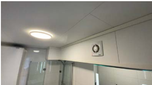
Mekanisk avtrekksvifte på vegg/kanal
