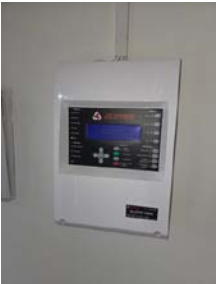
Felles brannsentral i felles gang ved hovedinngang
