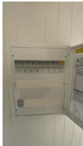
Sikringsskap er plassert i vindfang
