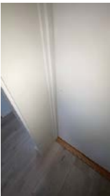
Overflateskade på dør til bad/vaskerom
