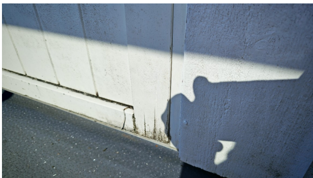
Slitasje på terrasse dør.
