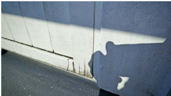
Slitasje på terrasse dør.
