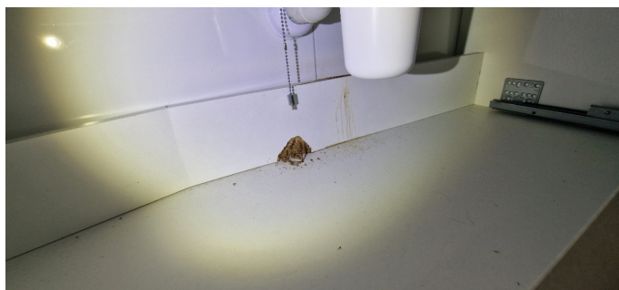
Skade på innredning.
