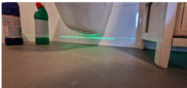
Manglende dreneringsløsning for innebygget sistene.
