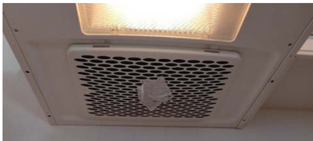
Funksjonstest av ventilator.
