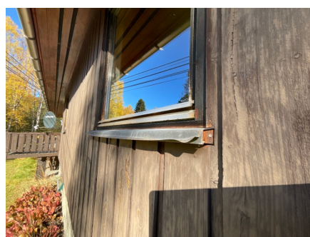
Plastisolering har løsnet fra blikk.
