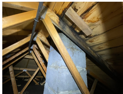
Eldre fuktmerker rundt pipe på kaldloft
