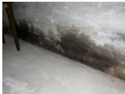
Salt/ kalkutslag på åpne vegger i kjeller
