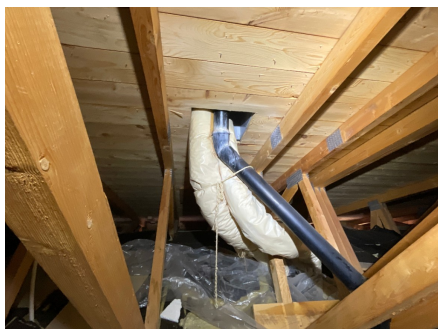
Kondensering på lufterør
