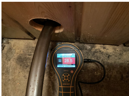
Fuktmåling inn i vegg i kjeller
