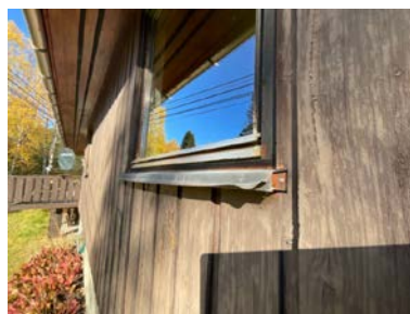
Plastisolering har løsnet fra blikk.
