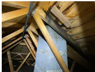
Eldre fuktmerker rundt pipe på kaldloft
