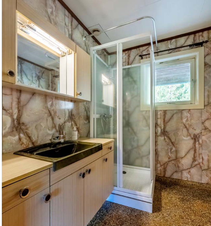
Bad med gulvvarme, innredning og dusjkabinett
