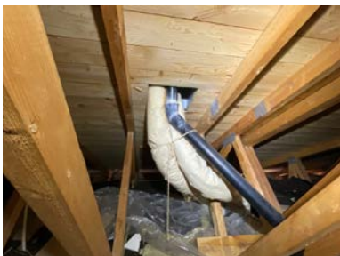
Kondensering på lufterør
