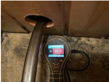
Fuktmåling inn i vegg i kjeller
