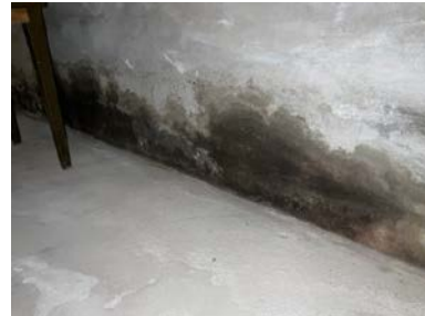
Salt/ kalkutslag på åpne vegger i kjeller
