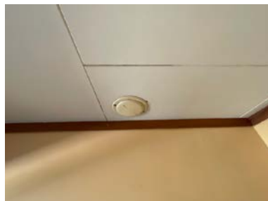
Fuktskader på himling ved ventil
